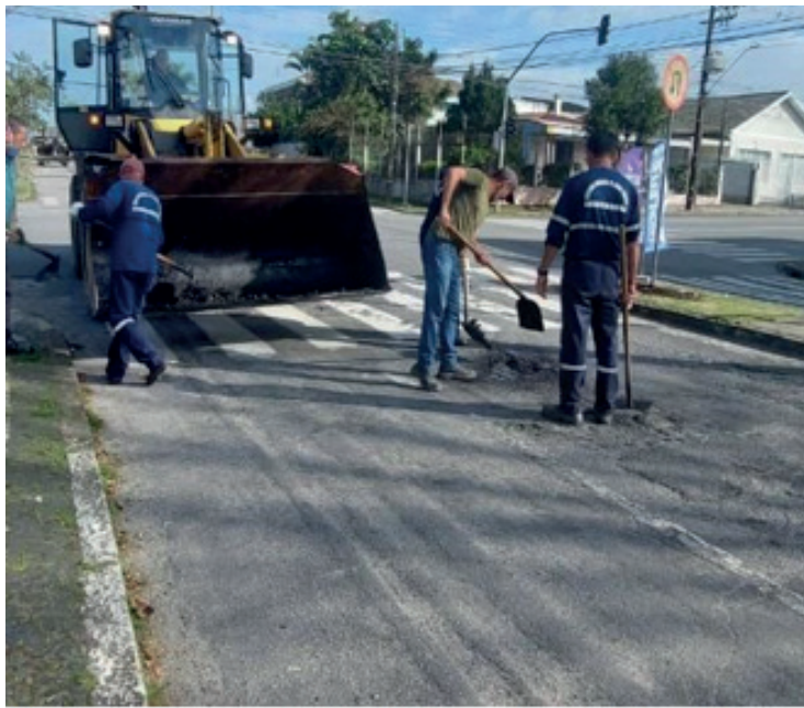
21. Tapa buraco na Av. Santa Rita – Alto São Sebastião
