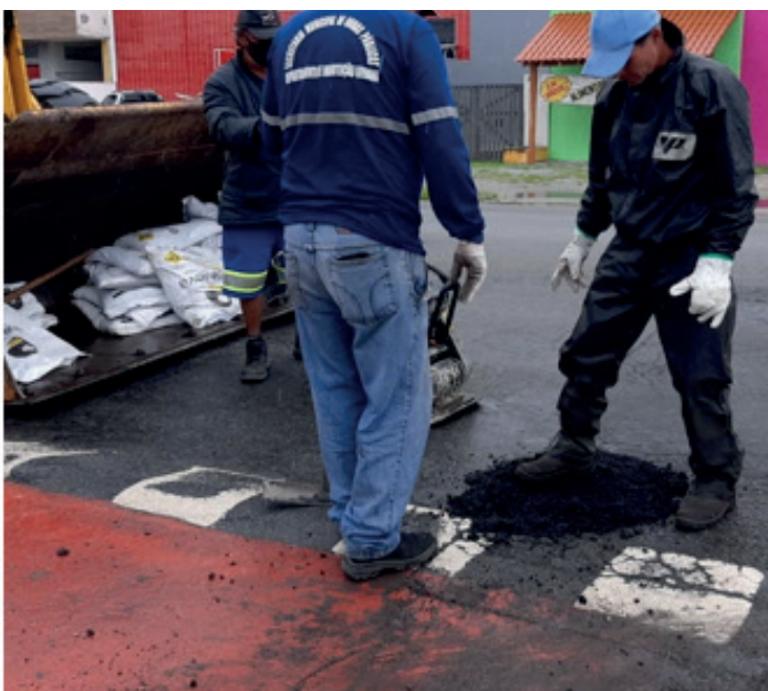
1. Tapa Buraco na Av. Bento Munhoz – Jardim Samambaia
