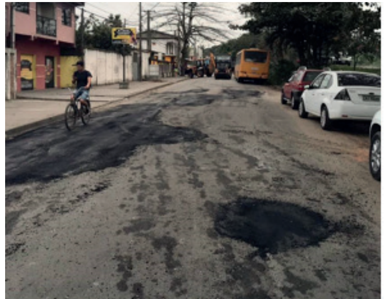
7. Tapa Buraco na Rua Paineiras – Jardim Iguaçu
